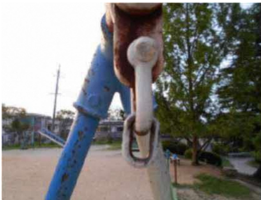
シャックル外れ状況
