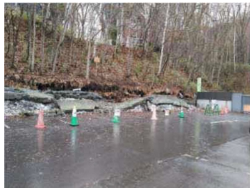
事故発生状況
