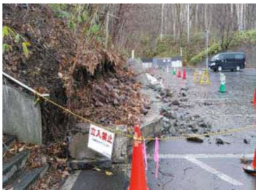
事故発生状況
