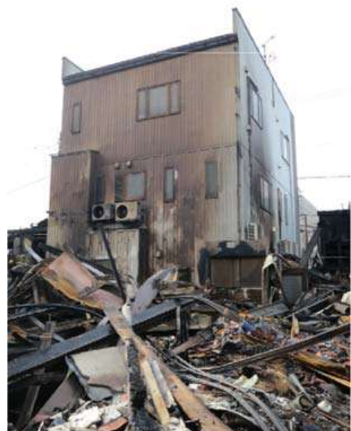
火元建物から5軒風下の準耐火建築物
