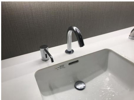
自動水栓（石垣市）
