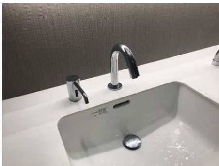
自動水栓（石垣市）
