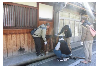
歴史的まちなみ保全活動 室外機の修景(本町地区)
