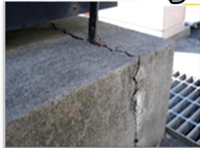
看板基礎部のひび割れ
