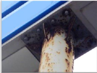
鉄骨接合部の腐食
