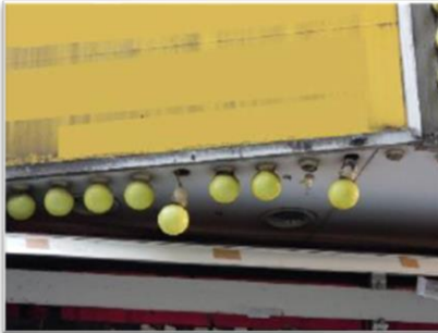
照明装置の破損、漏水
