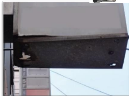
側板底部が腐食、破損
