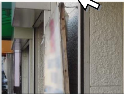
壁面取付け部の異常
