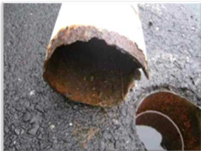
根腐れによる破断
