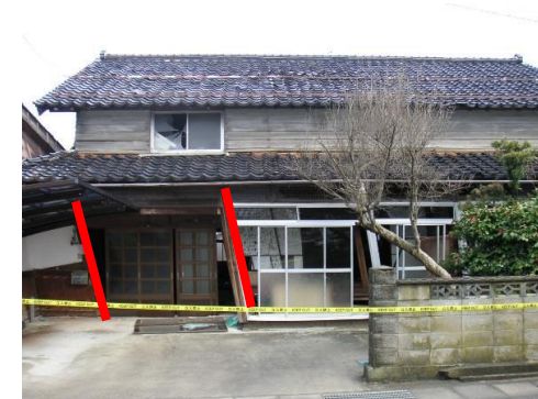
1 階部分が傾斜している
