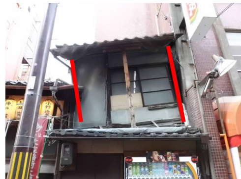
2 階部分が沈み込み全体的に傾斜している
