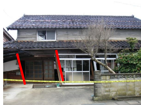
1 階部分が傾斜している
