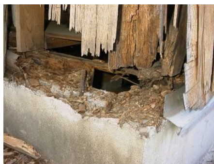
蟻害が発生し欠損している
