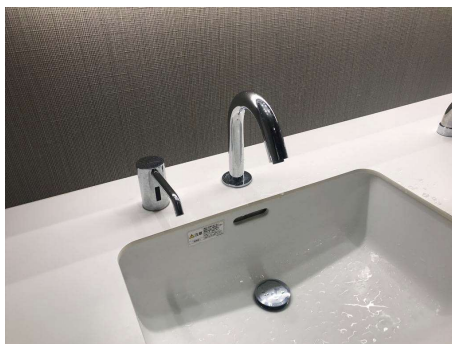
自動水栓（石垣市）
