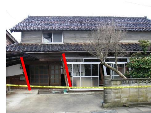
1 階部分が傾斜している
