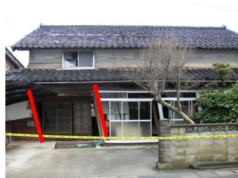
1 階部分が傾斜している
