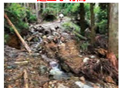
谷に盛土した作業道の崩壊
