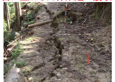
盛土で発生したクラック
