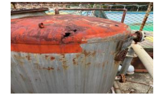
循環浄化装置の劣化(野田プール)
