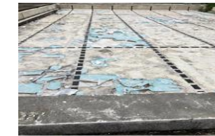
プール槽の劣化(山滝プール)
