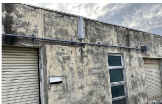
建築物の劣化(城北プール)
