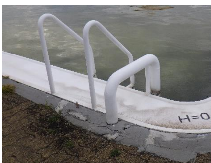
プールサイドの劣化(中央公園プール)
