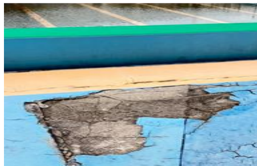
プールサイドの劣化(山直北プール)
