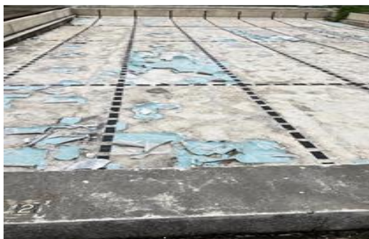
プール槽の劣化(山滝プール)
