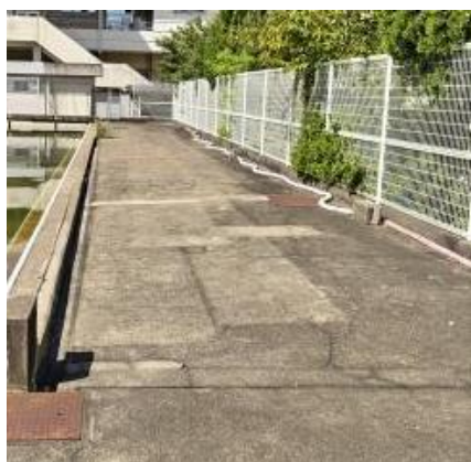
プールサイドの劣化(久米田中学校プール)
