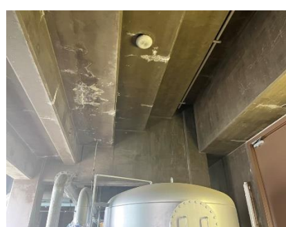
建築物の劣化(中央公園プール)
