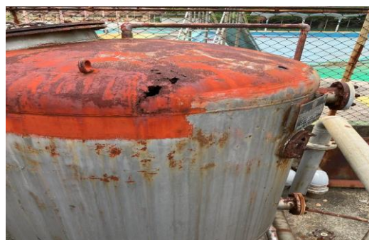
循環浄化装置の劣化(野田プール)
