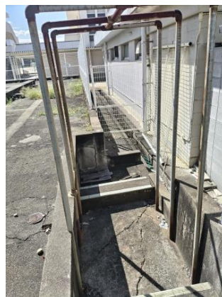
プールサイドの劣化(久米田中学校プール)
