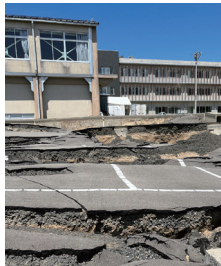
能登半島地震で 陥没した下水道管路
