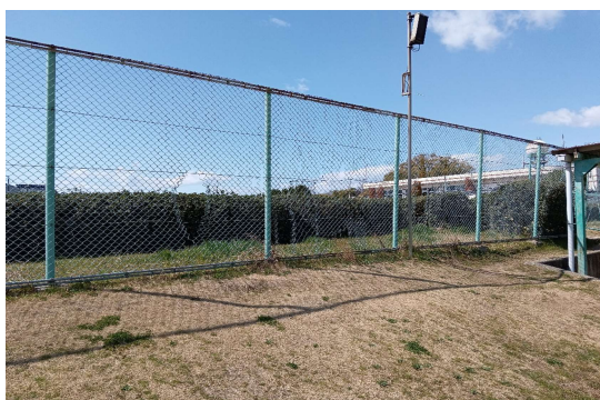
フェンスの劣化(中央公園テニスコート)
