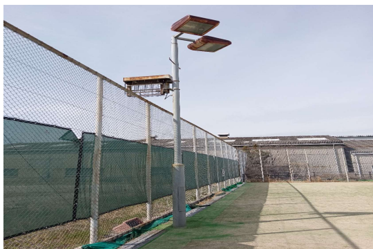
照明の劣化(牛ノ口公園テニスコート)
