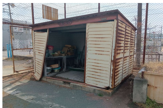
倉庫の劣化(春木台場テニスコート)
