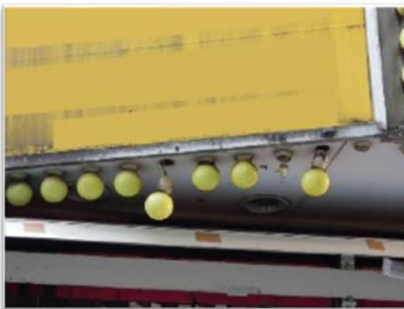
照明装置の破損、漏水
