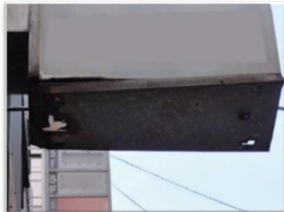
側板底部が腐食、破損
