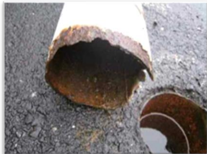
根腐れによる破断
