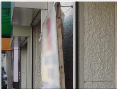
壁面取付け部の異常
