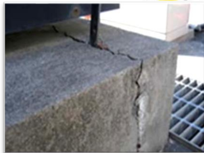
看板基礎部のひび割れ
