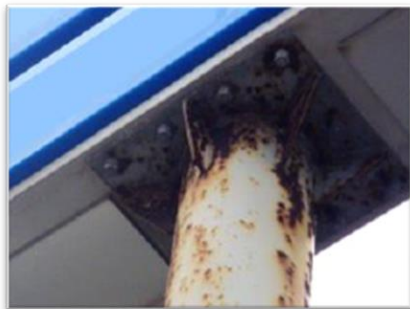
鉄骨接合部の腐食
