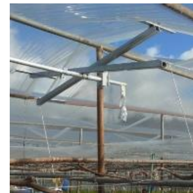
ぶどうハウスの 自動換気装置
