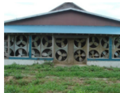
畜舎壁面の換気扇
