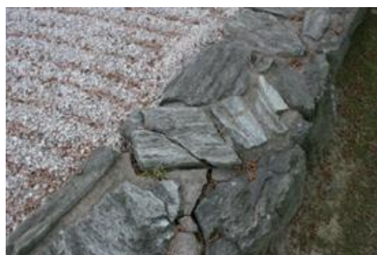
モルタルの割れ
