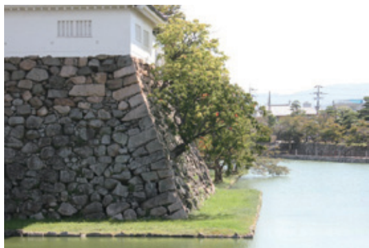
石垣から生えている樹木
