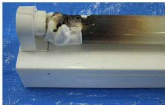
図 9. 直管 LED ランプの損傷例
