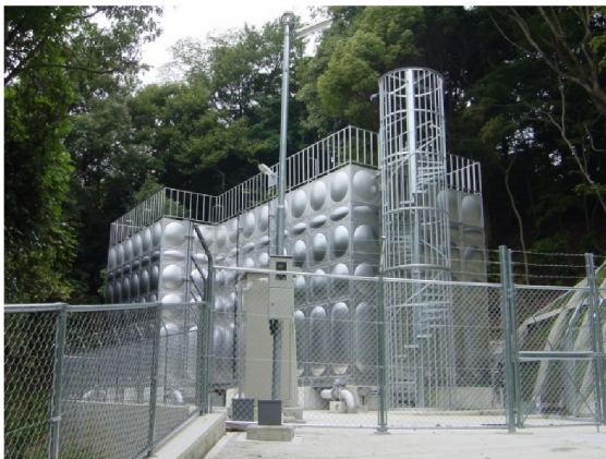
写真：神於配水池（耐震化済み）
