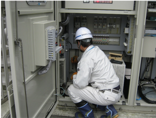
写真：配電盤の点検作業
