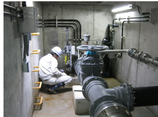
写真：緊急遮断弁*の点検作業
