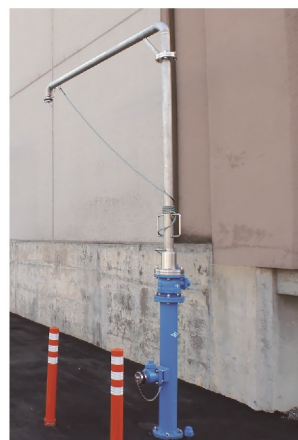
写真：給水車用応急給水栓
