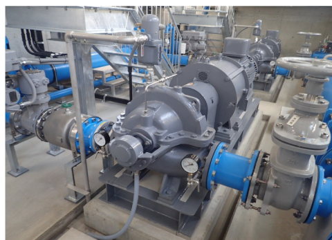
写真：更新後のポンプ設備
