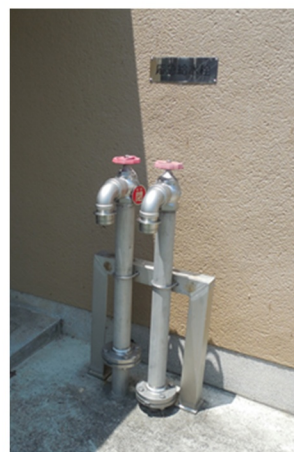
写真：応急給水栓
