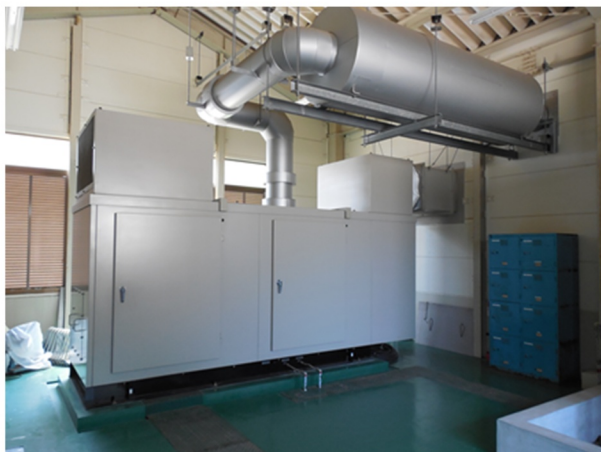
写真：自家発電設備
