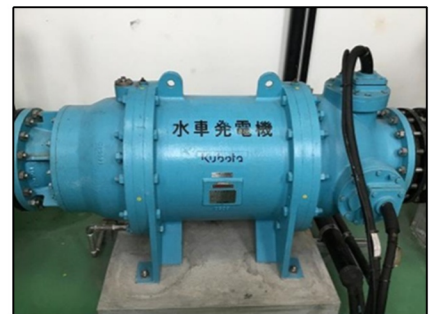
写真：小水力発電機
