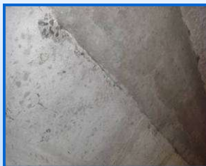
コンクリートのはぐり
