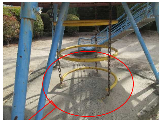
コンクリートの露出状況
