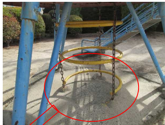
コンクリートの露出状況
