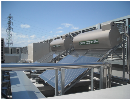
消防署に設置された太陽熱パネル
