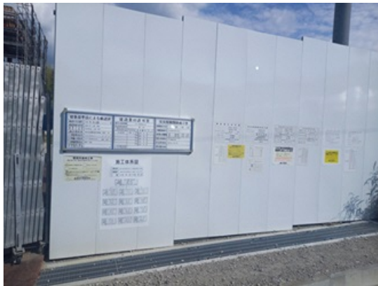
写真 2 看板類掲示状況
